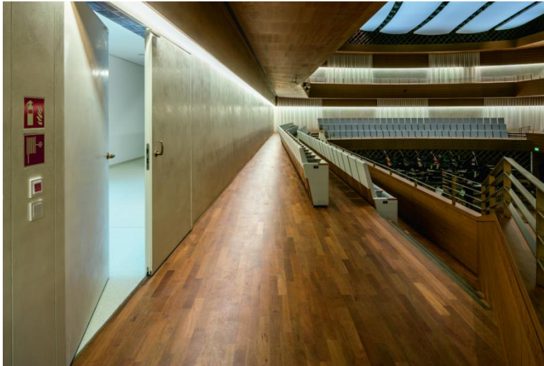
Bild 7: Bis zu drei Meter messen die Durchgangsbreiten der Schörghuber Brand- und Schallschutztüren zum großen Saal. Sie gewähren den Besuchern Einlass zu den Konzerten, sorgen für eine ungestörte Akustik und Brandschutz.
